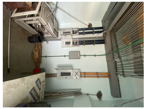
ภาพประกอบ : ห้องไฟฟ้าชั้น 7
